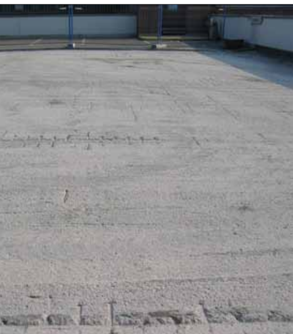
Abb. 1: Parkfläche vor der Sanierung mit deutlich sichtbaren Schäden.
